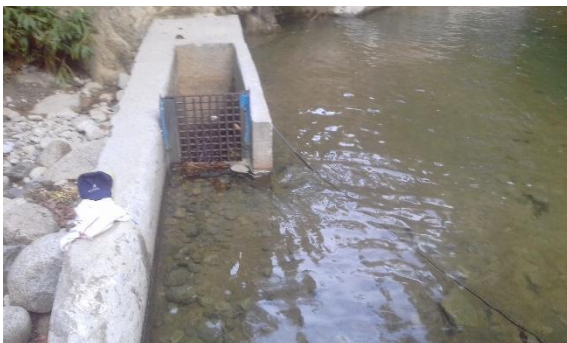
Punto de captación del acueducto (Quebrada Santa Gertrudis)
